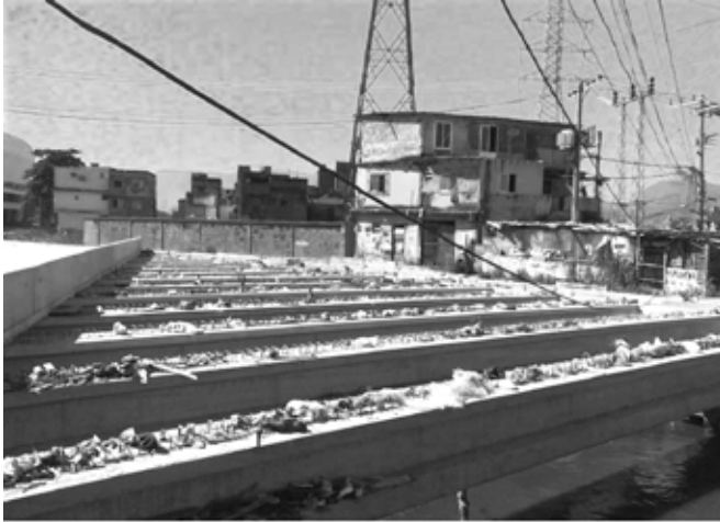
Obras do PAC sobre o rio Faria-Timbó. 04/02/2014. Acervo LTM. Fotos: Jorge Castro
