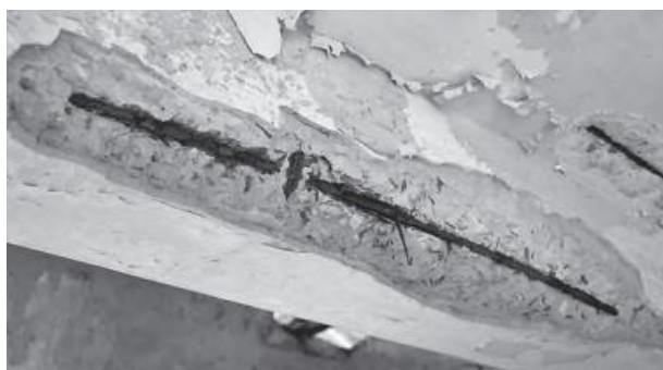
Figura 6 – Corrosão de armadura em uma viga.
