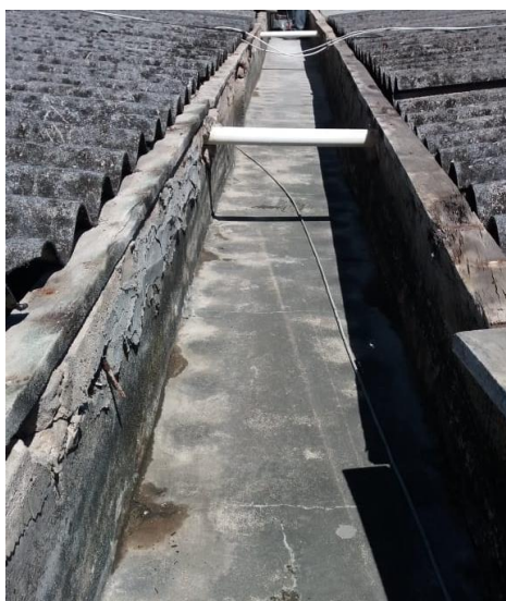
Figura 13 – Calhas da cobertura sem impermeabilização.
