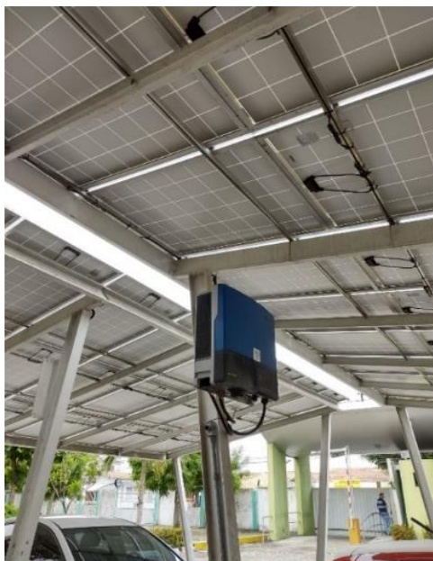
Figura 14 – Parte inferior da garagem solar do IFPB
