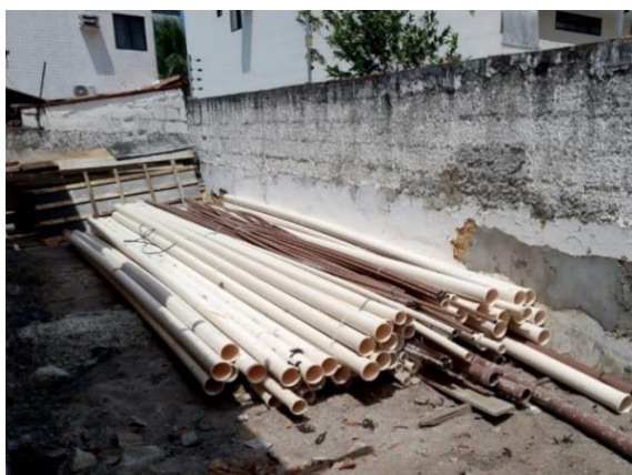
Figura 12 – Materiais de hidráulica
