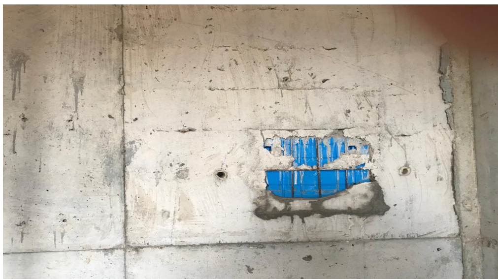
Figura 26: Bicheiras com armadura exposta
