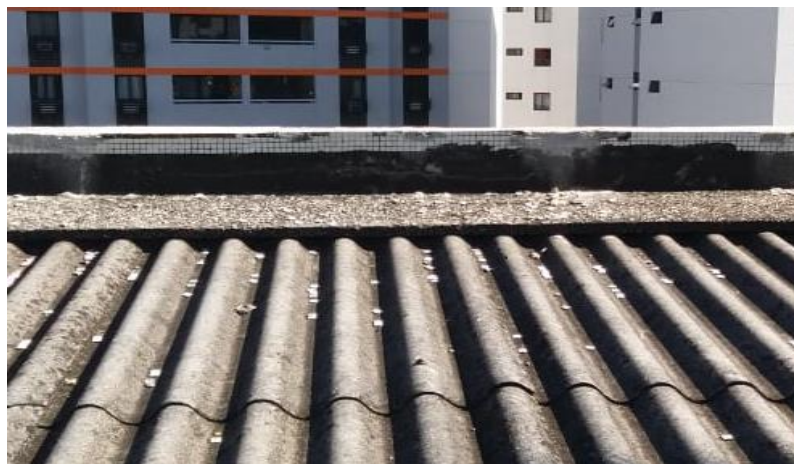
Figura 12 – Lado interno da platibanda sem impermeabilização com as telhas.
