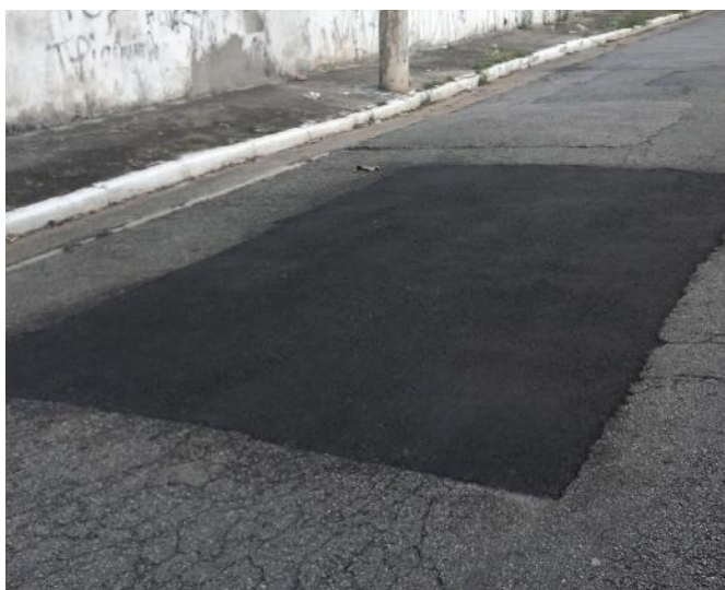
Figura 3 – Remendos realizados no pavimento
