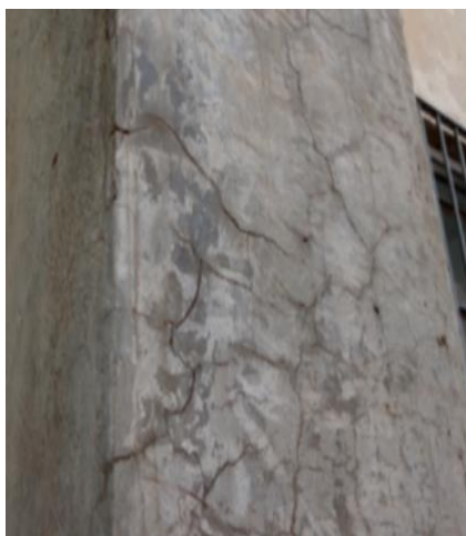
Figura 2 – Conjunto de fissuras em um pilar.
