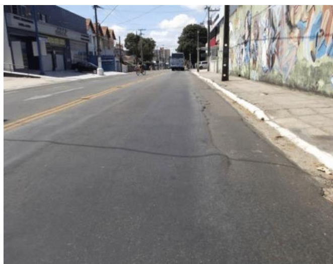
Figura 2 – Afundamento com trilho de roda
