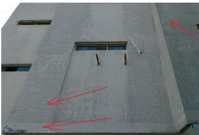
Figura 15 – Deslocamento cerâmico na fachada Sul da edificação
