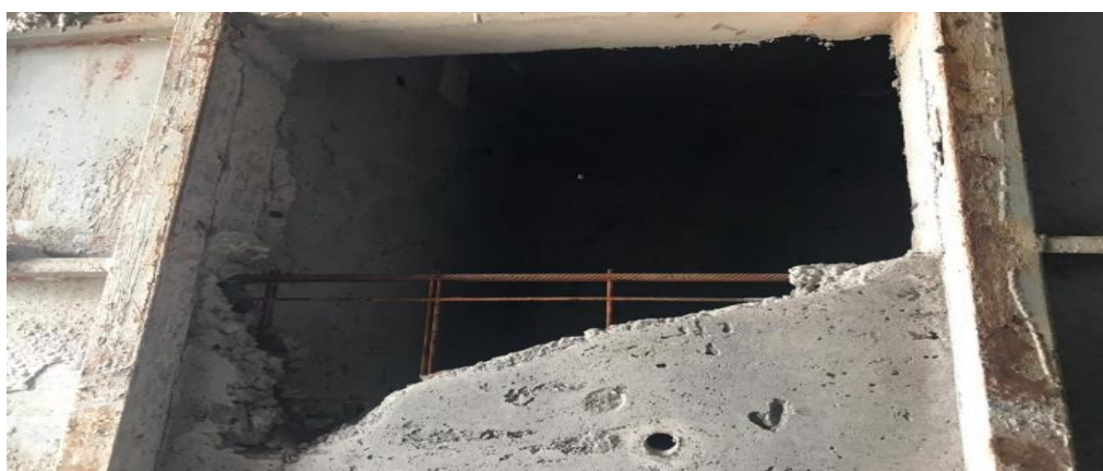
Figura 12: Bicheira e armadura exposta
