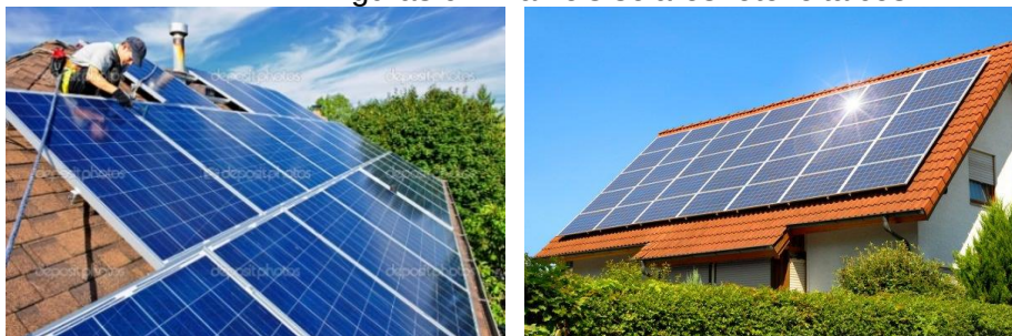
Figuras 9 – Painéis solares fotovoltaicos
