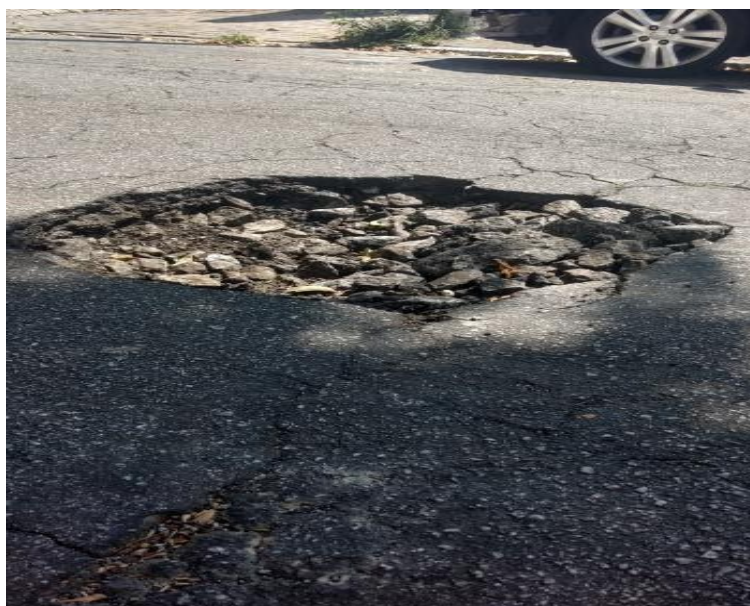
Figura 4 – Panela, patologia gravíssima
