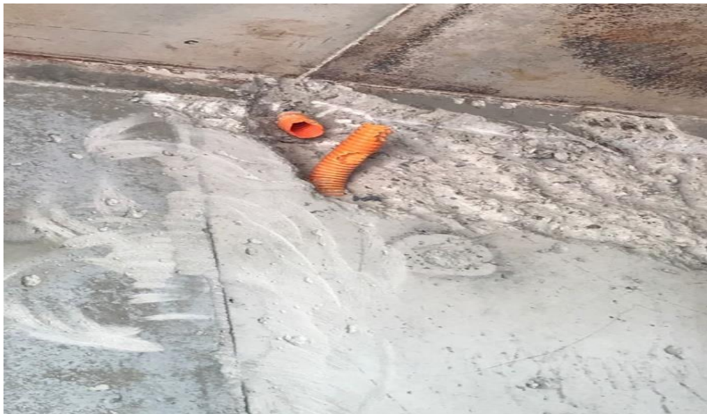
Figura 11: Eletrodutos rompidos na concretagem
