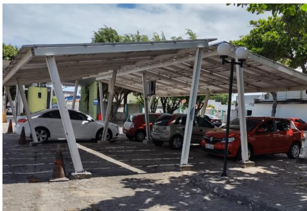
Figura 15 – Vista lateral da garagem solar do IFPB
