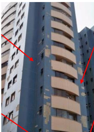
Figura 5 – Deslocamento de revestimento cerâmico.
