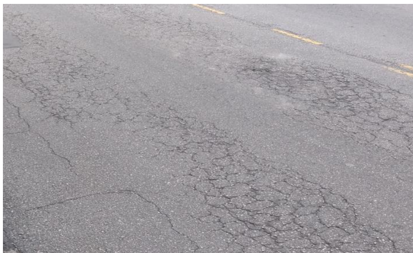
Figura 1 – Trincas com deformação permanente apresentando visíveis desgastes
