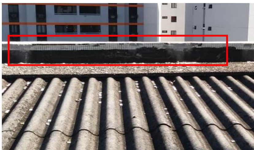
Figura 14 – Deslocamento cerâmico na lateral da platibanda junto à coberta.
